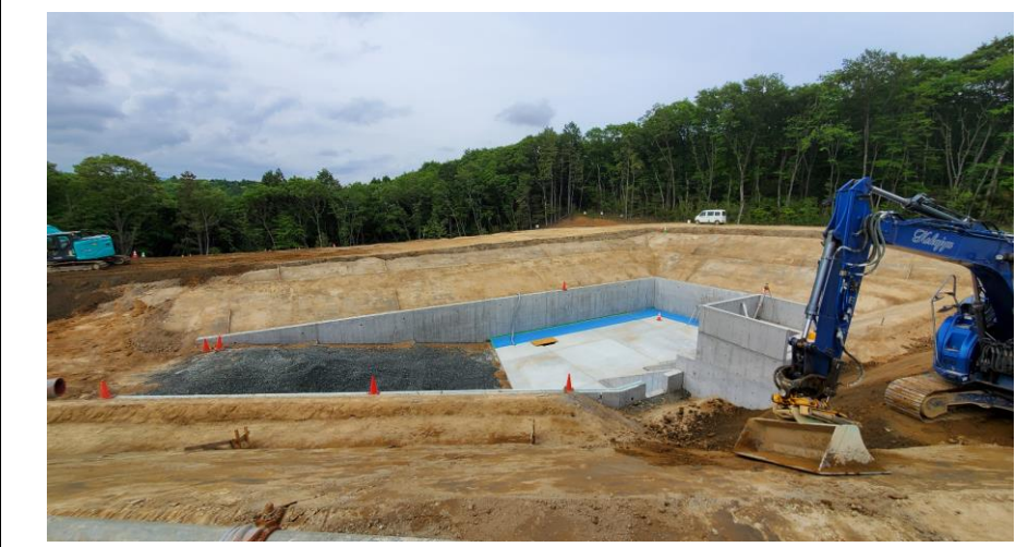
No.68 令和4年5月撮影 工事種別 外構工事 状況 調整池工事（築堤工事）
