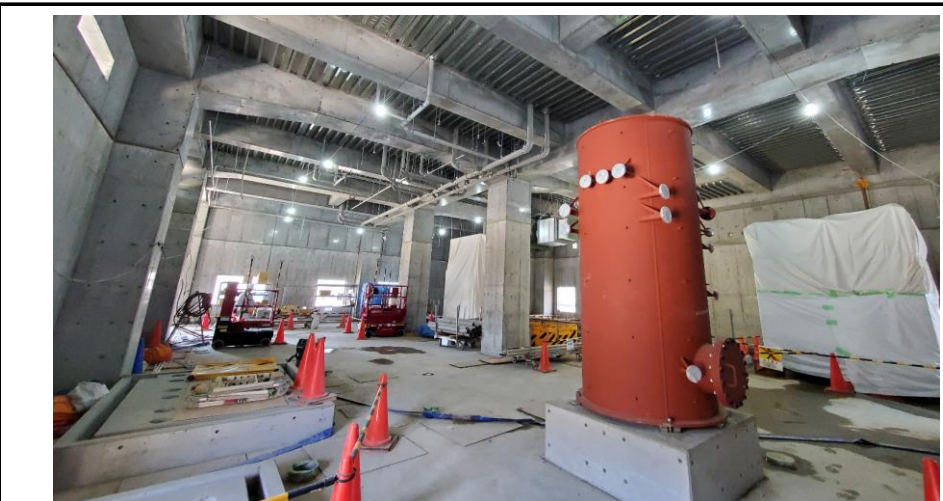
No.66 令和4年5月撮影 工事種別 プラント設備 状況 焼却施設（焼却炉室側・設備据付状況）
