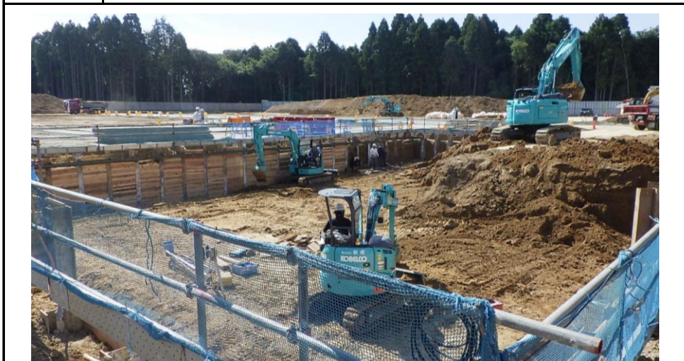
No.11 令和3年7月撮影 工事種別 地業・基礎・土工事 状況 土工事（ごみピット1次掘削工事）
