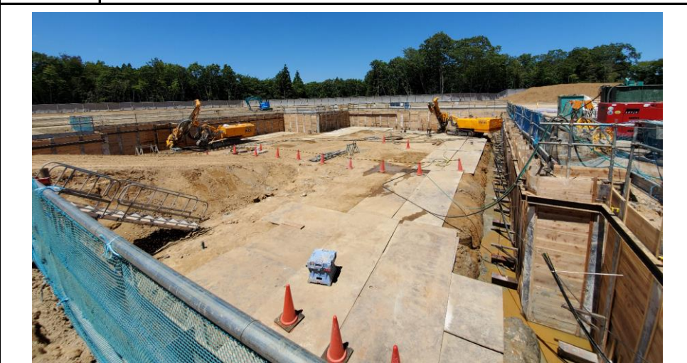
No.12 令和3年7月撮影 工事種別 地業・基礎・土工事 状況 土工事（ごみピット1次掘削工事）
