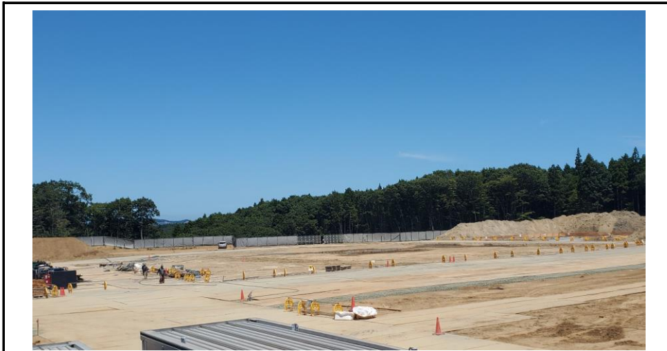
No.9 令和3年7月撮影 工事種別 地業・基礎工事 状況 地業工事（杭工事完了）
